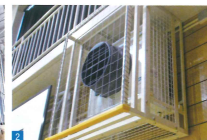
2 キャットウォーク下に吊下げ設置
