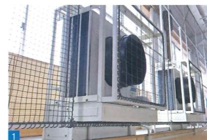
1 キャットウォーク上に床置き設置
