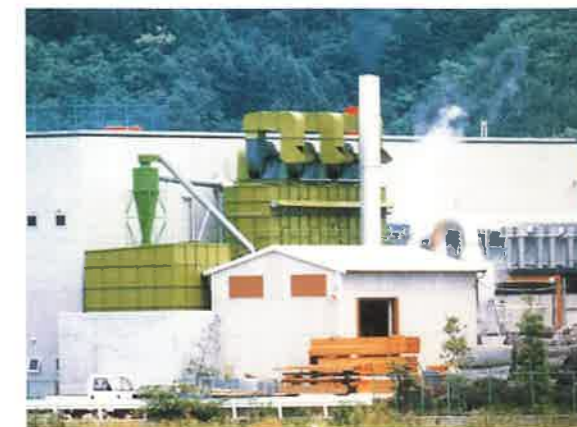
BFS-180P型・ST-80型・ボイラーYT-2000 (2t)
