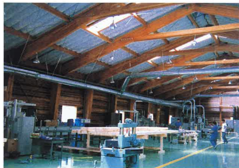
プレカット工場用集塵装置 屋内ダクト配管
